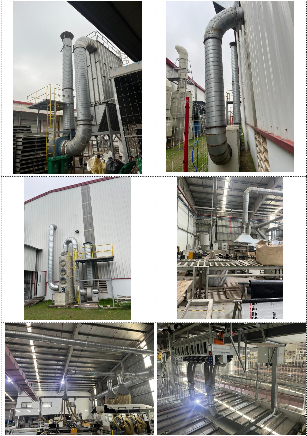
Hình 19. Một số hình ảnh hệ thống thu gom và xử lý khí thải của cơ sở
